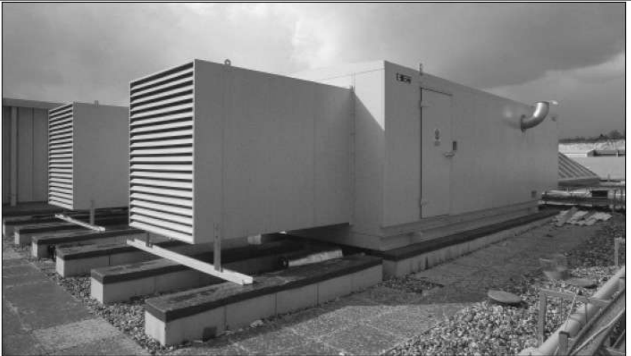
Два маломощных дежурных агрегата по 1000 кВА с «навесными» корпусами на крыше здания устраняют множество проблем, но создают другие
