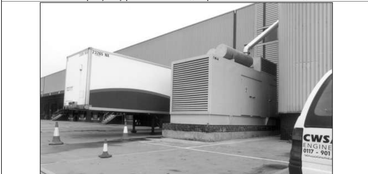
Сверхмалошумный (75 дБ(А) на 1 м) автоматический дежурный агрегат на 1000 кВА на складе крупной сети гипермаркетов.
