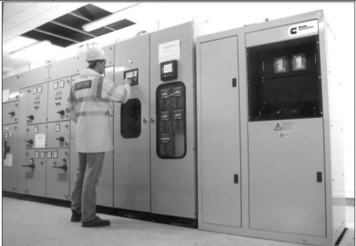
Шкаф цифрового главного контроллера (DMC), установленный рядом с распределительной аппаратурой водных компаний. Доступ осуществляется спереди.
