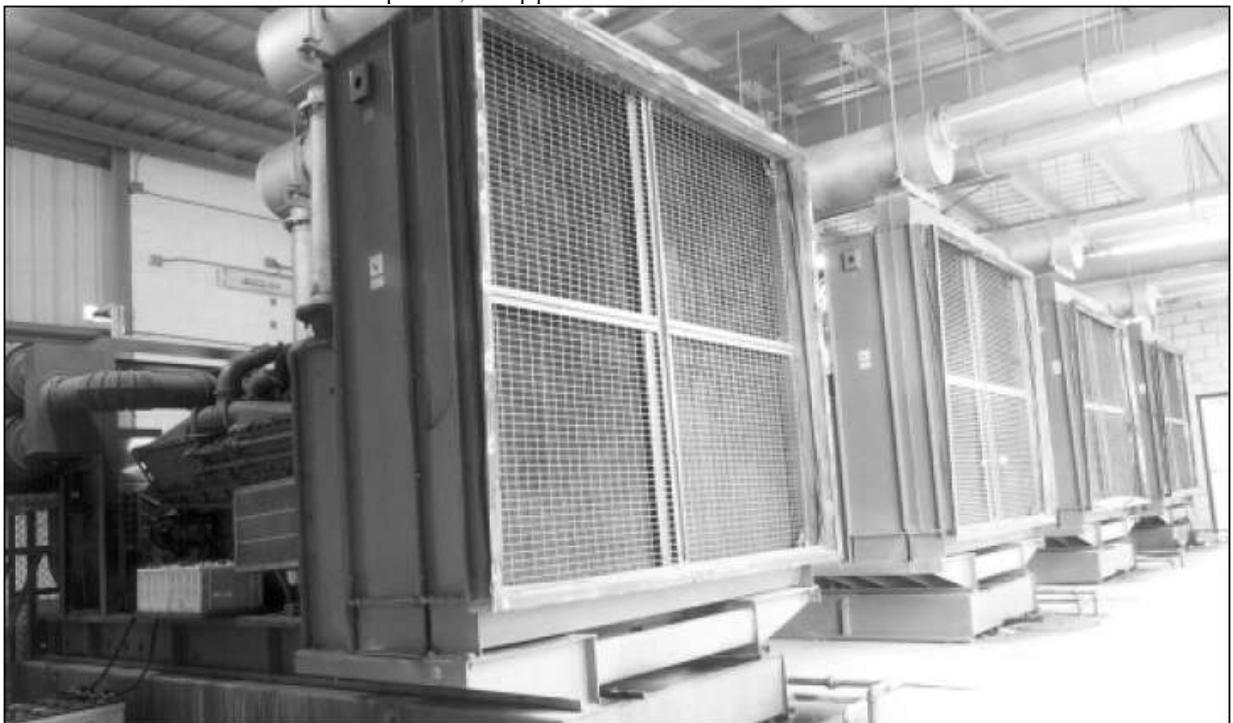
Четыре агрегата по 150 кВА с двигателями KTA50 работают с базисной нагрузкой в Саудовской Аравии
