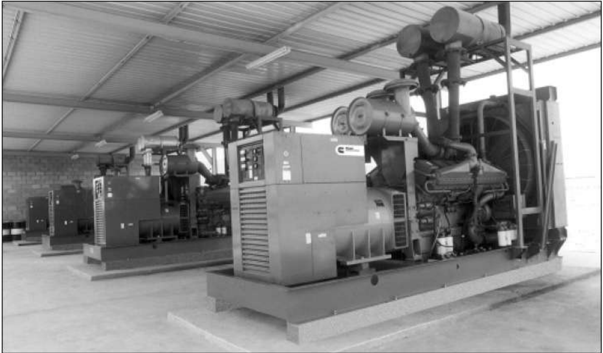
Установка 4-х агрегатов по 800 кВА каждый в машинном зале на уровне земли с простой, но эффективной выхлопной системой
