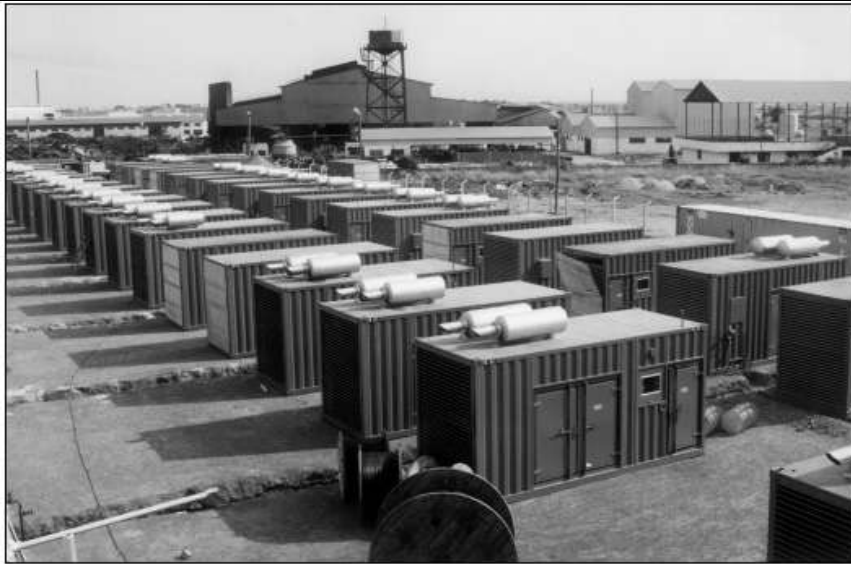
Типовая электростанция Cummins на 30 МВт на стройплощадке в Африке
