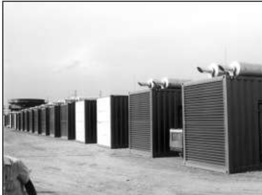
Многоагрегатная установка из 28 генераторных агрегатов по 1 МВт каждый обеспечивает постоянную мощность 20 МВт
