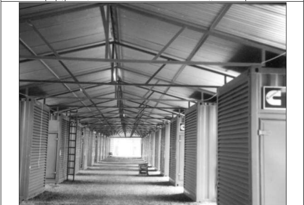
Станция из нескольких низковольтных генераторов
