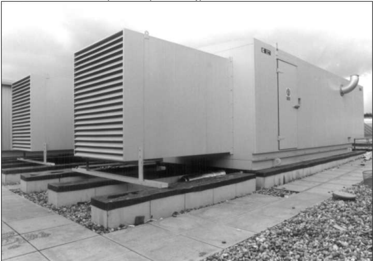
Два агрегата по 1000 кВА, установленные на крыше универмага с максимальным шумоподавлением и расширенными аттенуаторами.
