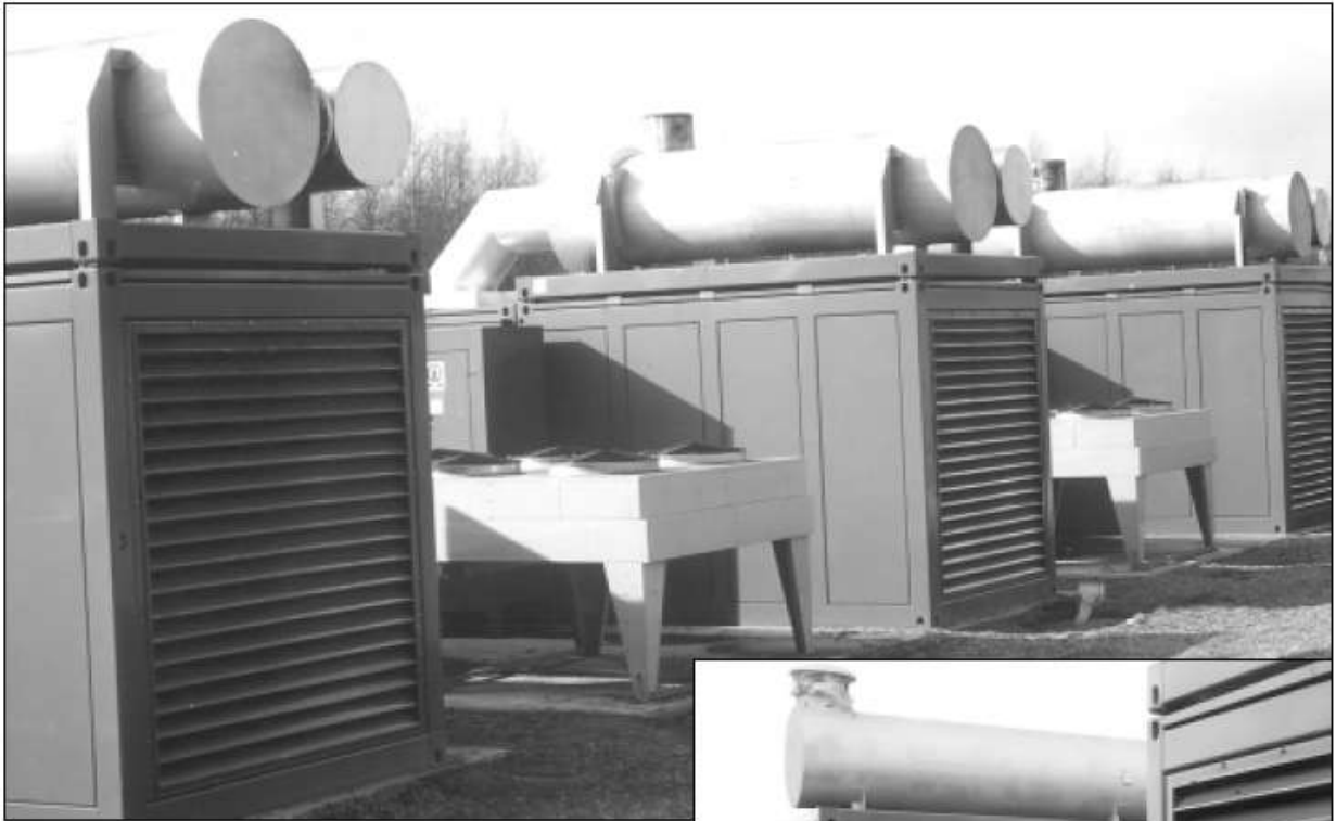
Контейнеризованные высоковольтные агрегаты на 1,57 МВт, используемые для снижения пиковых нагрузок, с горизонтальными наружными охлаждающими радиаторами. Вся установка шумоизолирована до 75 дБ(А) на расстоянии 1 м; на расстоянии примерно 50 футов шум не слышен.
