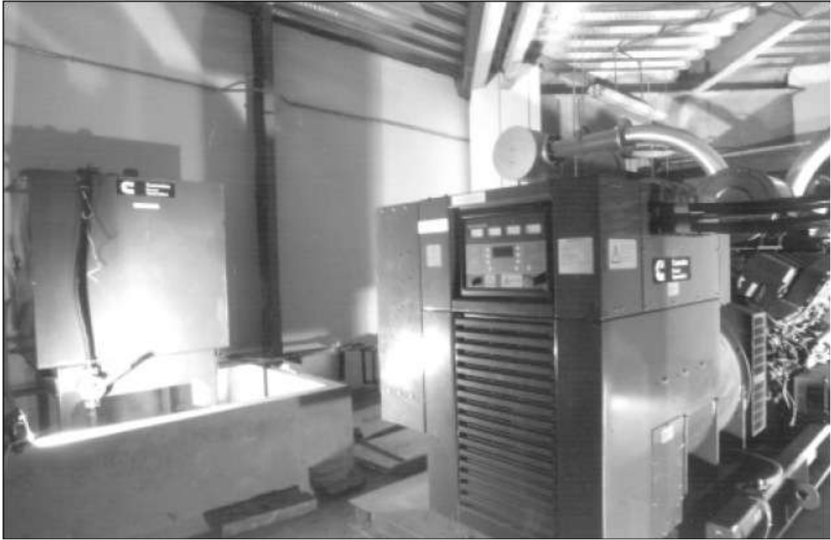
Пример отдельной установки топливного бака на 900 литров в пределах стенки поддона
