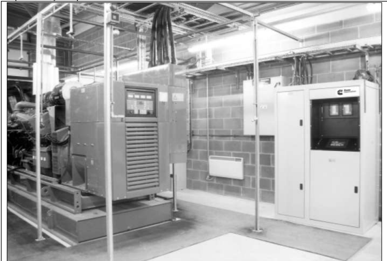
Подводка кабелей к модулю панели управления со шкафом цифрового главного контроллера (DMC) и настенная коробка контакторного переключателя рядом с генераторным агрегатом.
