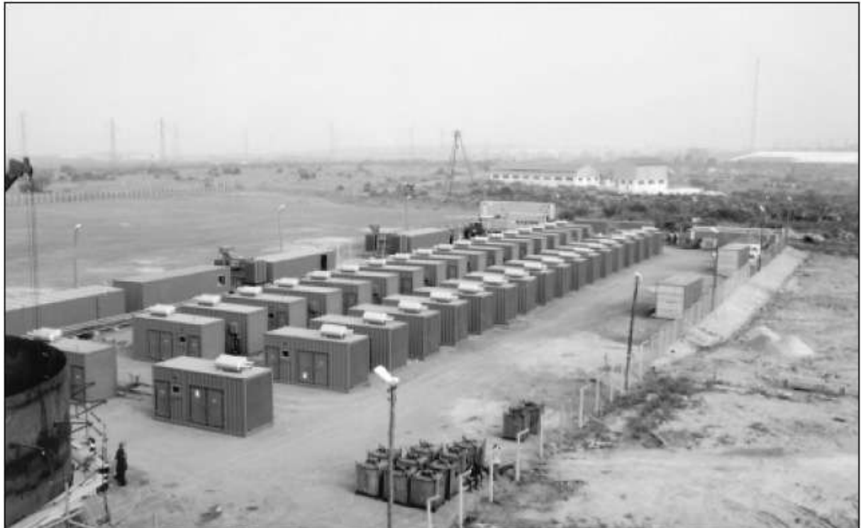
Тридцать девять агрегатов по 1125 кВА с двигателями KTA50 работают параллельно с использованием систем управления PCC и DMC, вырабатывая в совокупности 30 МВт энергии.
