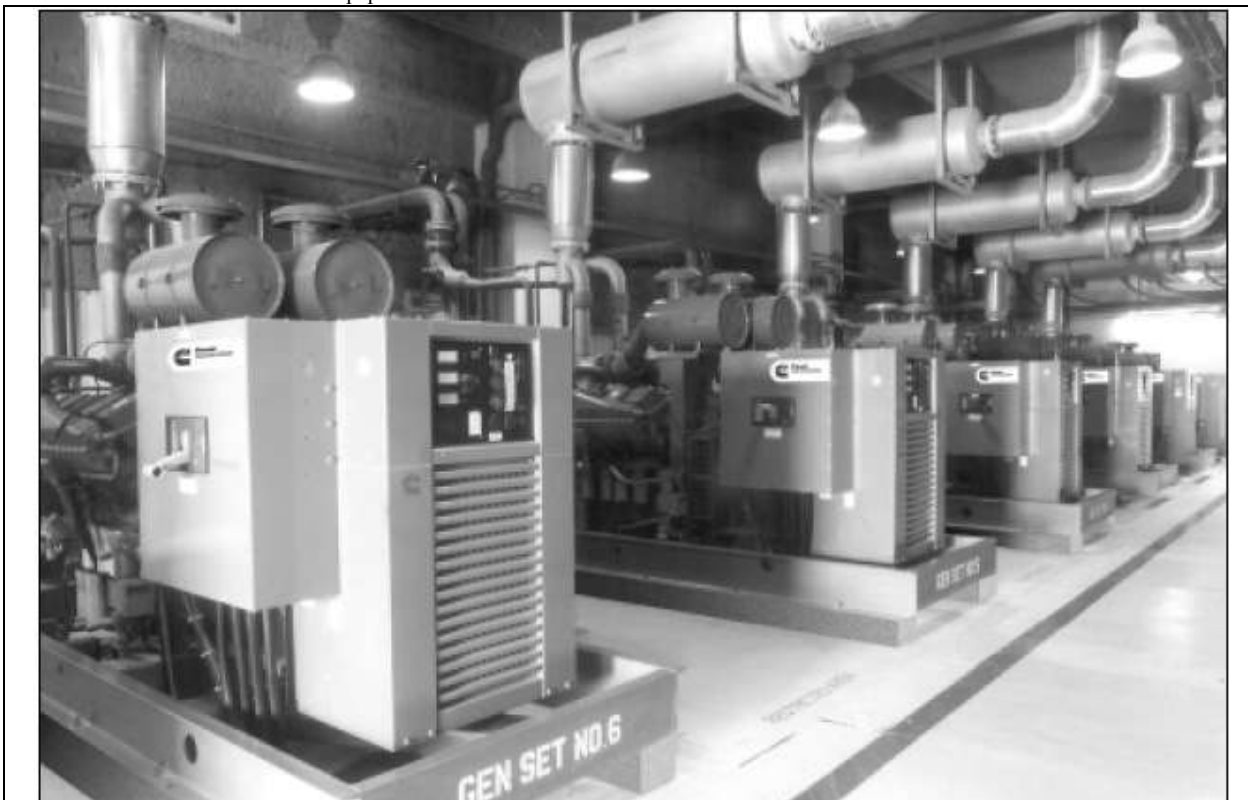
Девять генераторных агрегатов по 900 кВА работают параллельно с использованием системы управления РССР на фабрике по разливу напитков на Среднем Востоке
