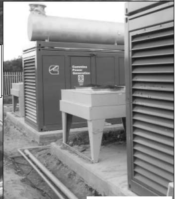
Топливопроводы и дополнительная кабельная разводка
