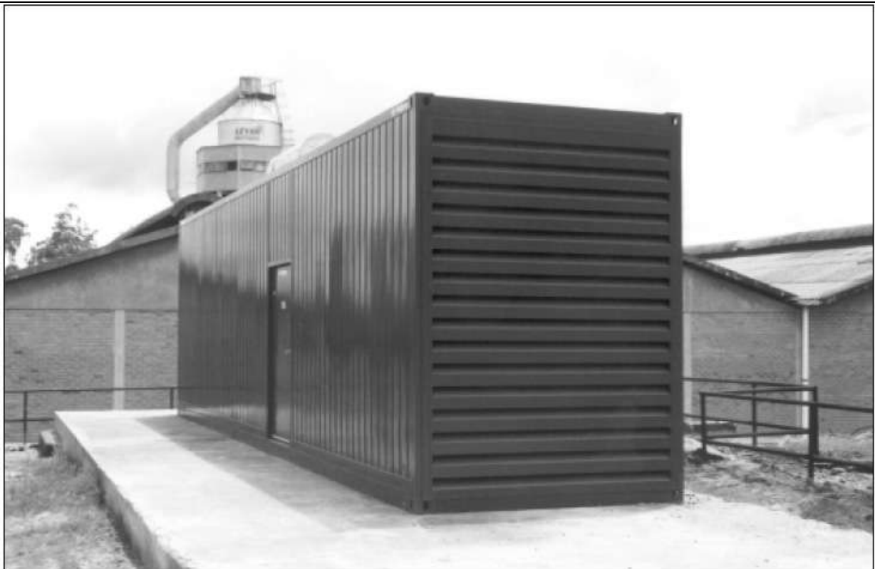
Контейнер ISO 30 футов (9 м) с аварийным генератором на 600 кВА. Уровень шума снижен до 75 дБ на расстоянии 1 метр
