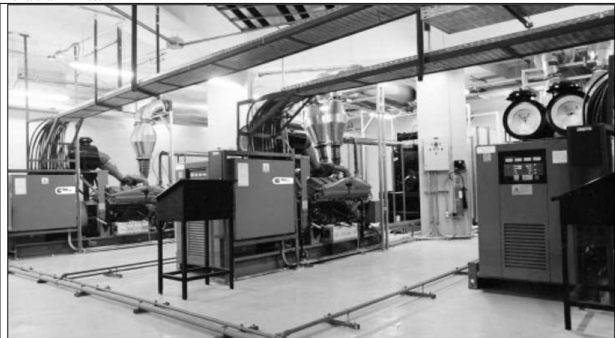
Три дежурных агрегата по 1 МВт каждый с приводом от двигателей Cummins KTA38G4, установленные в больнице и оснащенные каталитическими конвертерами с целью уменьшения выхлопных выбросов.
