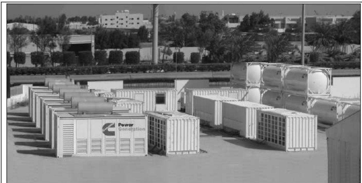
Пример электростанции на 5 МВт из 7 генераторных агрегатов по 1 МВт каждый. Обратите внимание на использование 20-футовых контейнеров для размещения трансформаторов, поста управления и распределительной аппаратуры. Справа штабелированы цистерны с топливом по 22000 литров каждая, установленные в специальные рамы.
