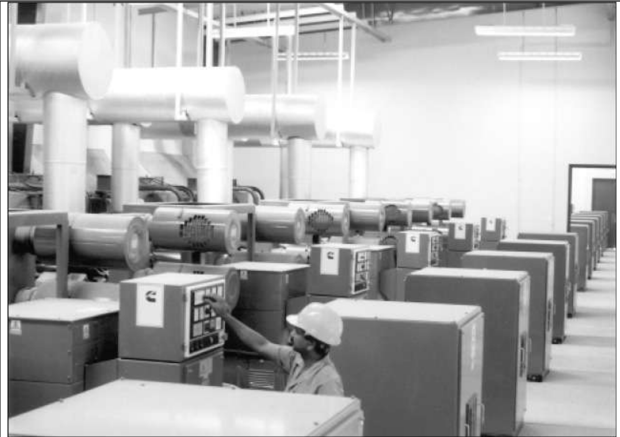
Двенадцать агрегатов по 1250 кВА работают вместе в качестве источника основного питания строительного лагеря с использованием системы управления PCL
